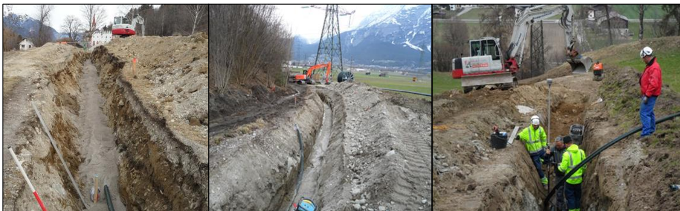
Das Team von Fröschl Bau bei der Verlegung der Trinkwasserleitung im offenen Graben.
